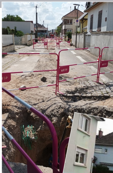
Sécurisation de la sortie de la rue des Sœurs par la création d'un plateau rue principale
